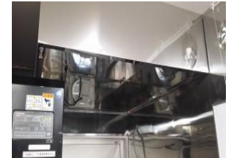
空気換気設備 （調理場）
