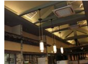
空気換気設備 （店内）
