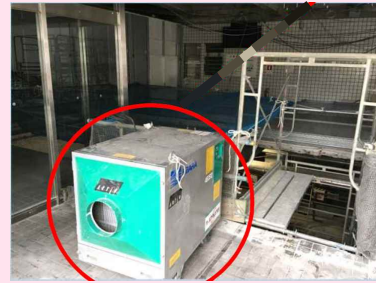
集塵機を設置し室内の換気を実施
