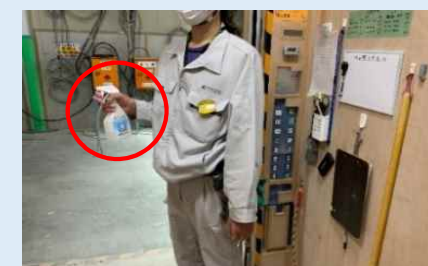
EVの操作盤等の消毒を徹底
