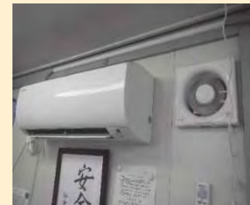
扇風機や換気扇とエアコンを併用
