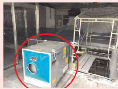
集塵機を設置し室内の換気を実施
