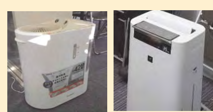
空気清浄機を設置
