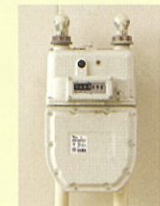
ガスメーター
