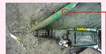
コンクリート内のガス管を ドリルにより損傷した例
