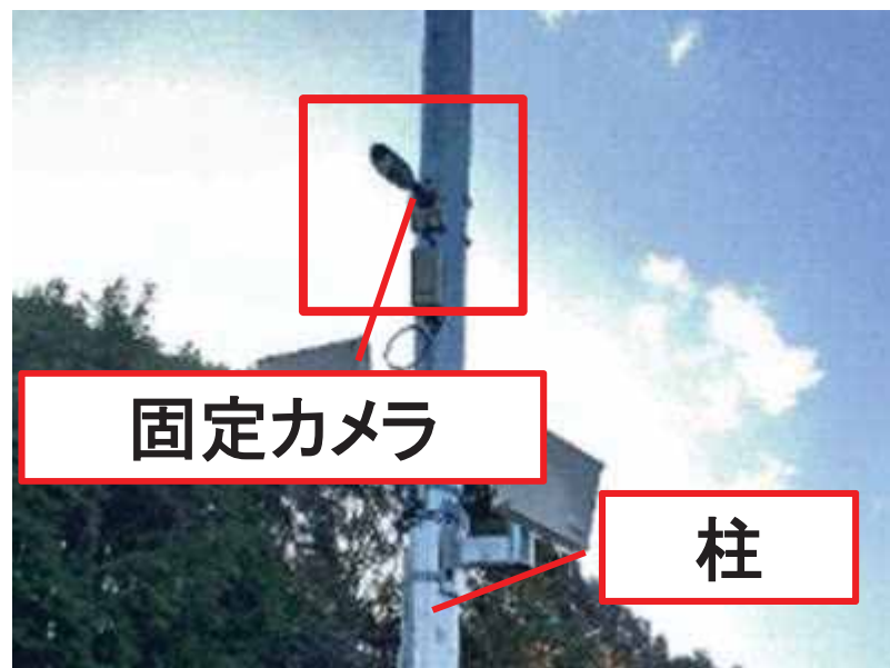
平成30年度固定カメラ設置例
